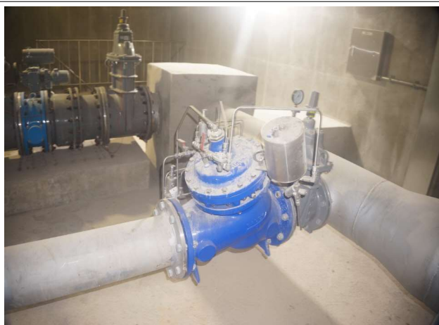
밸브실 설비 상태양호(1)
