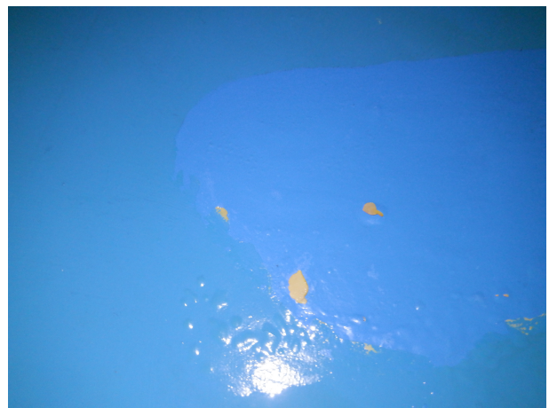
배수지 1지 바닥슬래브 도장박리, 박락
