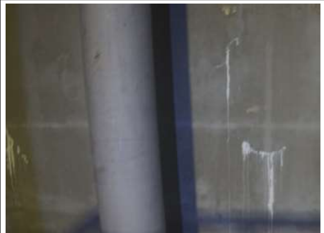
밸브실 지하2층 벽체 백태
