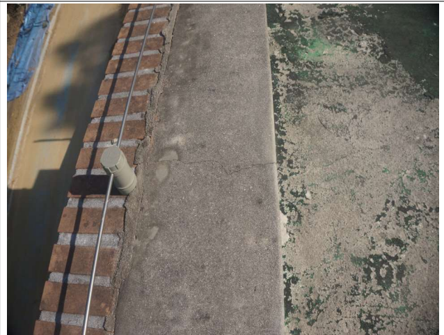
건축물 옥상층 파라펫 균열(0.3mm미만)
