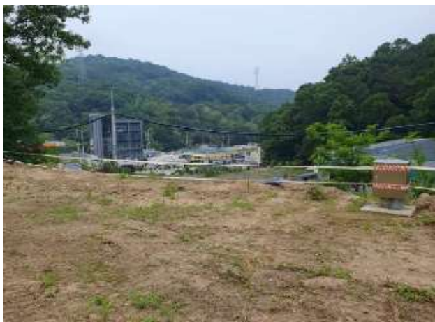
토사유실에 의한 웬스 파손[2024년 상반기 정기]
