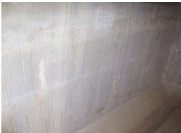
밸브실 지하2층 벽체 백태
