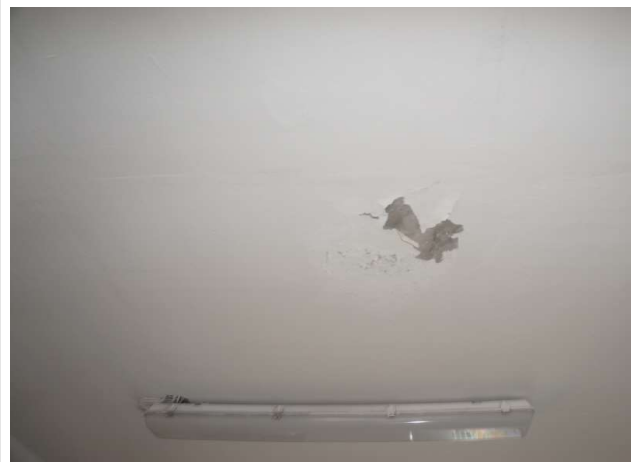
1층 건축물 내부 천장슬래브 도장박락
