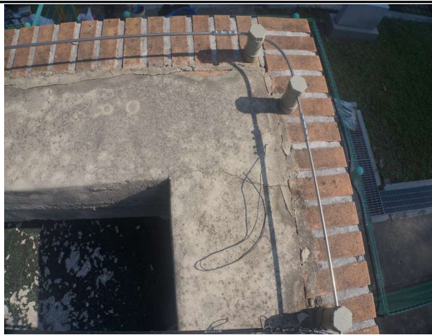
건축물 옥상층 파라펫 균열(0.3mm이상)
