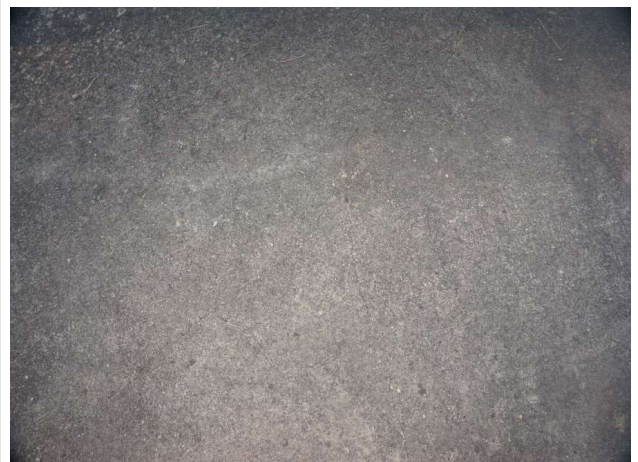
건축물 외부 바닥 균열(0.3m이상)
