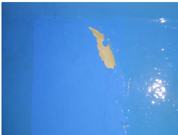
배수지 1지 바닥슬래브 도장박리, 박락
