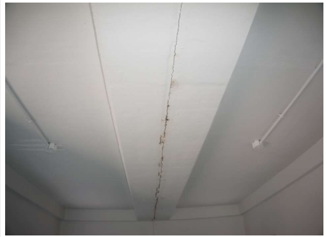
1층 건축물 내부 보 이음부 실링재 이격
