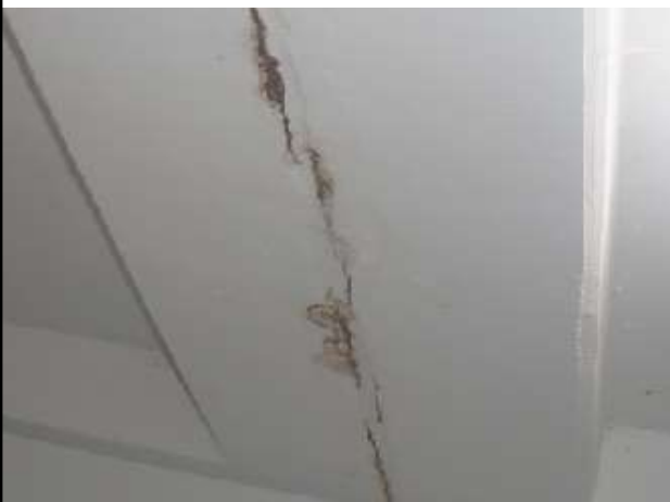
1층 건축물 내부 보 이음부 누수
