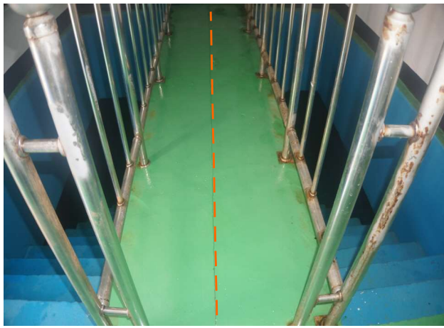
1층 건축물 내부 바닥슬래브 이음부 실링재 이격
