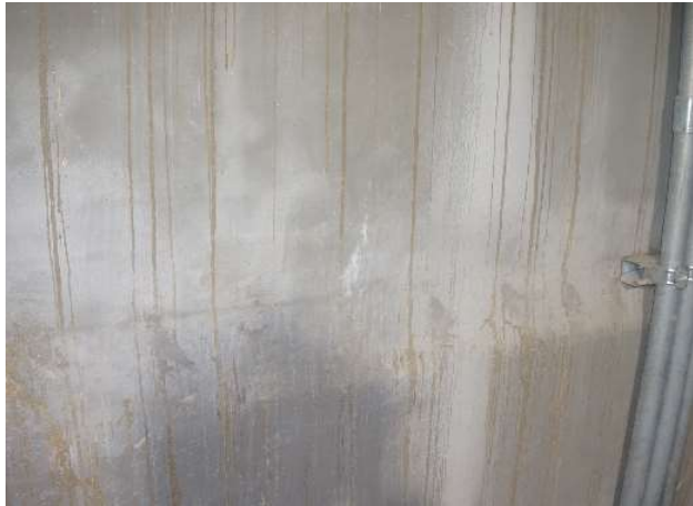
밸브실 지하2층 벽체 백태
