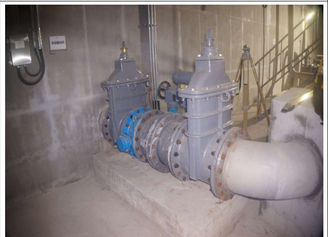
밸브실 설비 상태양호(2)
