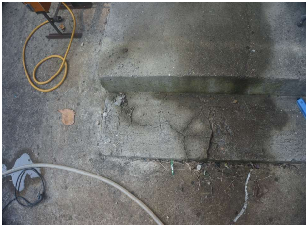
건축물 외부 출입부 계단 모르타르 파손
