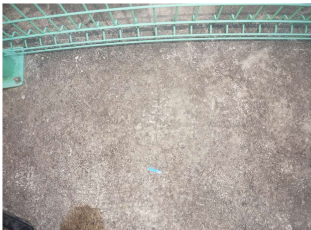
건축물 외부 바닥 균열(0.3m이상)
