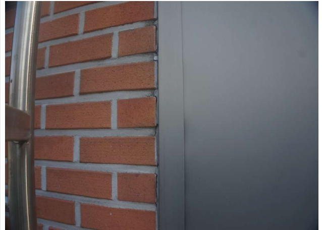
건축물 외부 이음면 실링재 이격
